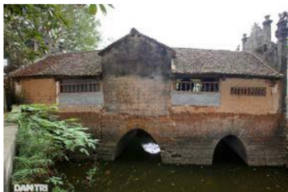
Hình 44. Cầu Khum, Làng Yên, Xã Thạch Xá, Huyện Thạch Thất, Hà Nội
