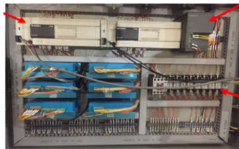
d) Tủ điện điều khiển
