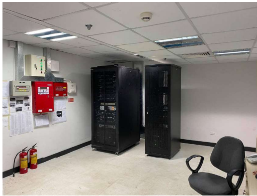
Hình 3. Khu vực lắp đặt hệ thống điều khiển chữa cháy của Hochiki
