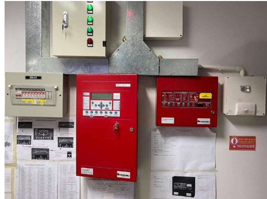
Hình 4. Hệ thống điều khiển chữa cháy của Hochiki
